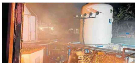
Detalle de la estación de bombeo tras sofocar el incendio. c7
